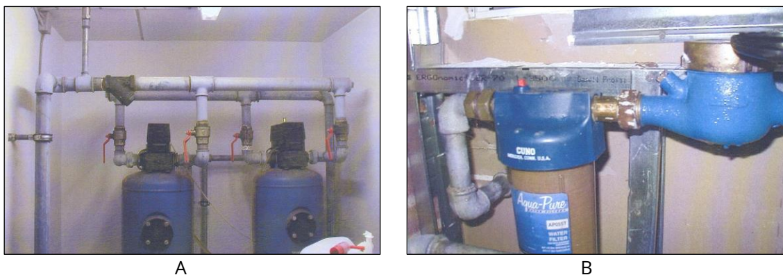
Figur 2.1. A: Forkert/ulovlig installation af blødgøringsanlæg i forbindelse med fællesvaskeri. Der er bl.a. fejl i forbindelse med monteringen af tilbagestrømningssikringen. B: Ulovligt filter anbragt uden tilbageløbssikringer før vandmåler i installation i børneinstitution.
